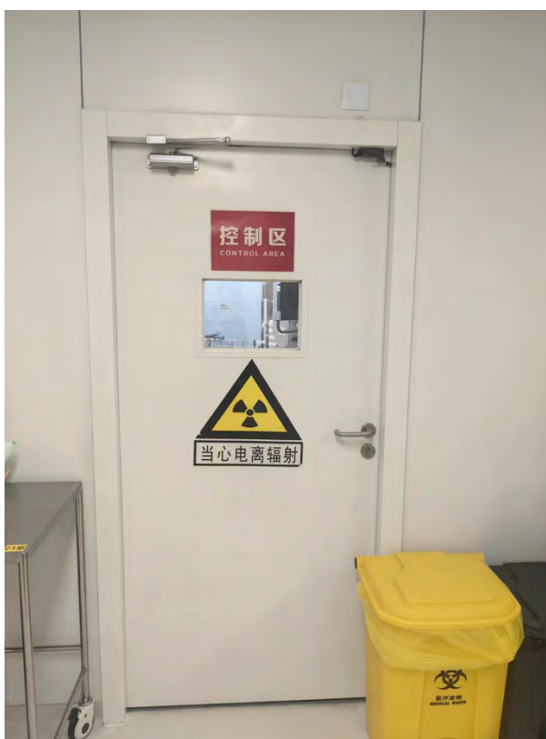
控制室与机房防护门电离辐射标志、分区标志和闭门器
