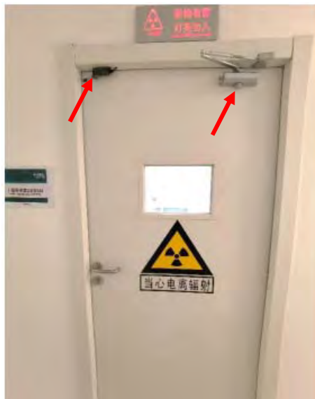
控制室防护门外电离辐射警告标志、闭门器和门一灯关
