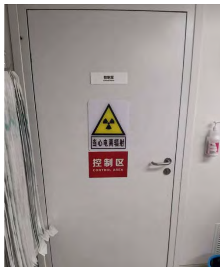
控制室防护门外电离辐射警告标志、分区标志
