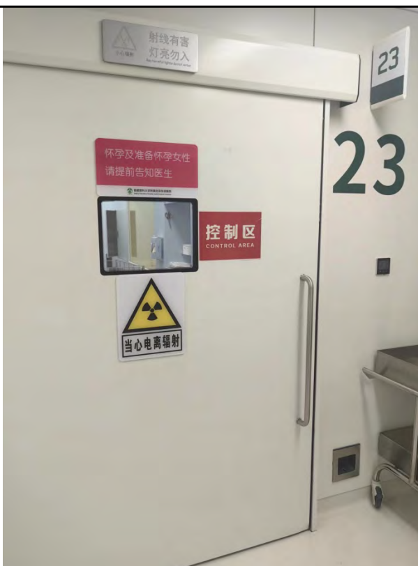
患者防护门上方电离辐射标志、分区标识、警示灯、脚踏式门控开关
