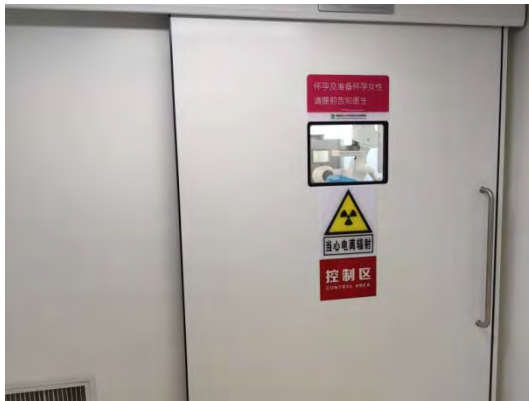
患者防护门外电离辐射警告标志和警示灯、分区标志
