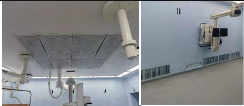
通风系统送/排风口
