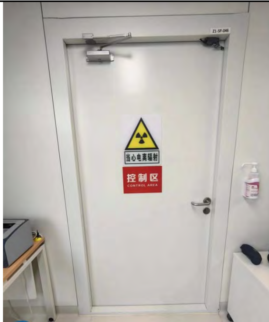
控制室防护门外电离辐射警告标志和闭门器、分区标志
